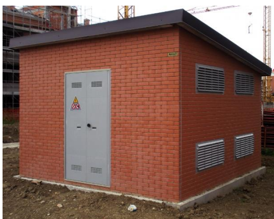
tipo cabina ENEL rivestita
